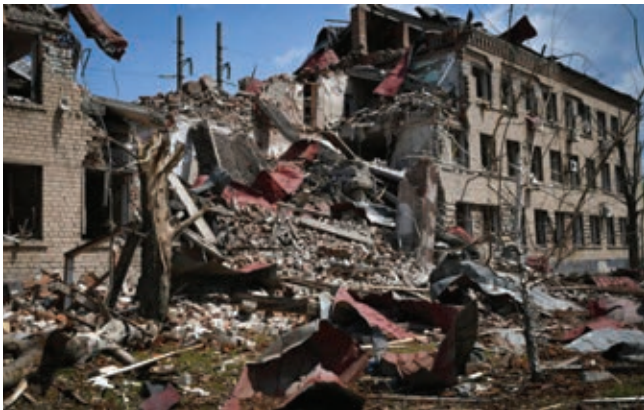
Εικ. 2. Κατεστραμμένο από τους ρωσικούς βομβαρδισμούς κτίριο στην Ουκρανία.
